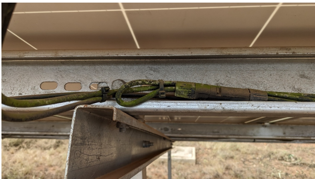
Figure 11 : Connecteurs présentant une corrosion externe
