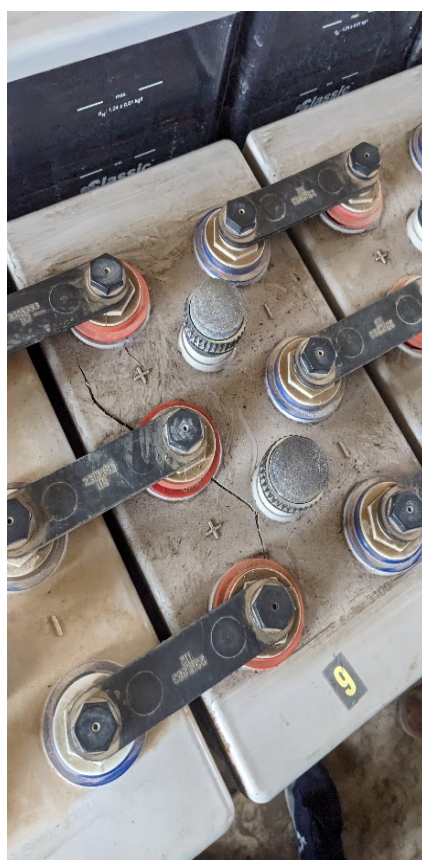
Figure 22 : Exemple de connecteurs trop serrés ayant endommagé l'enveloppe du module de batterie.
