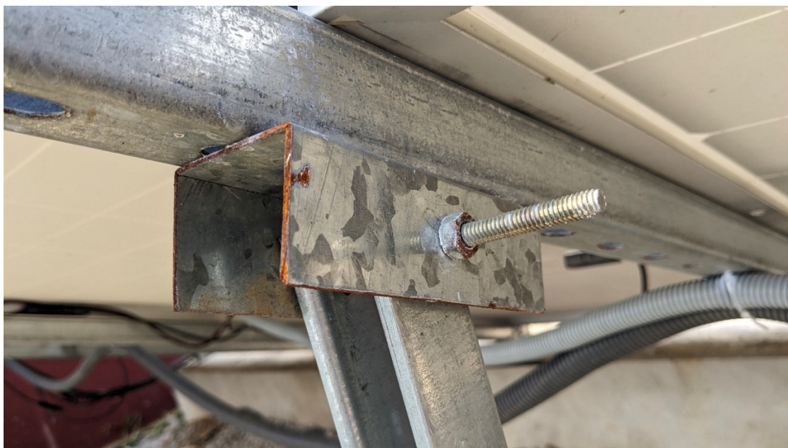
Figure 6 : Exemple de corrosion sur les structures causée par le choix d'un métal inadapté
