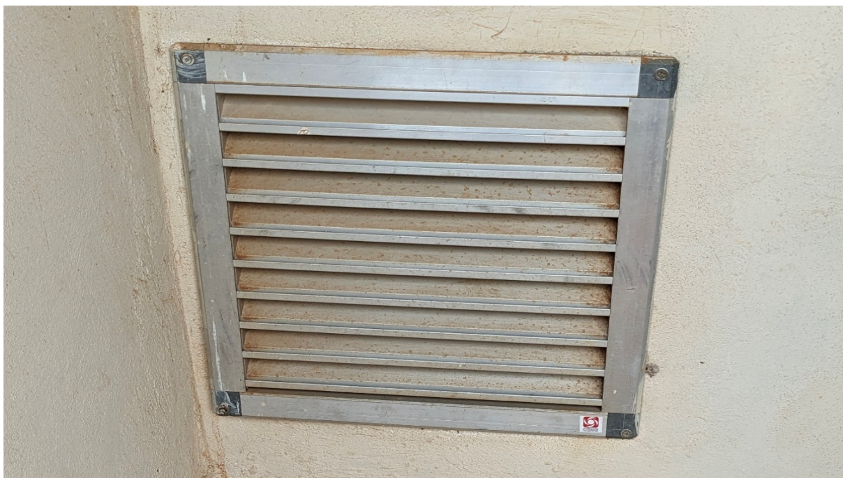
Figure 19 : Exemple de grille de ventilation à nettoyer
