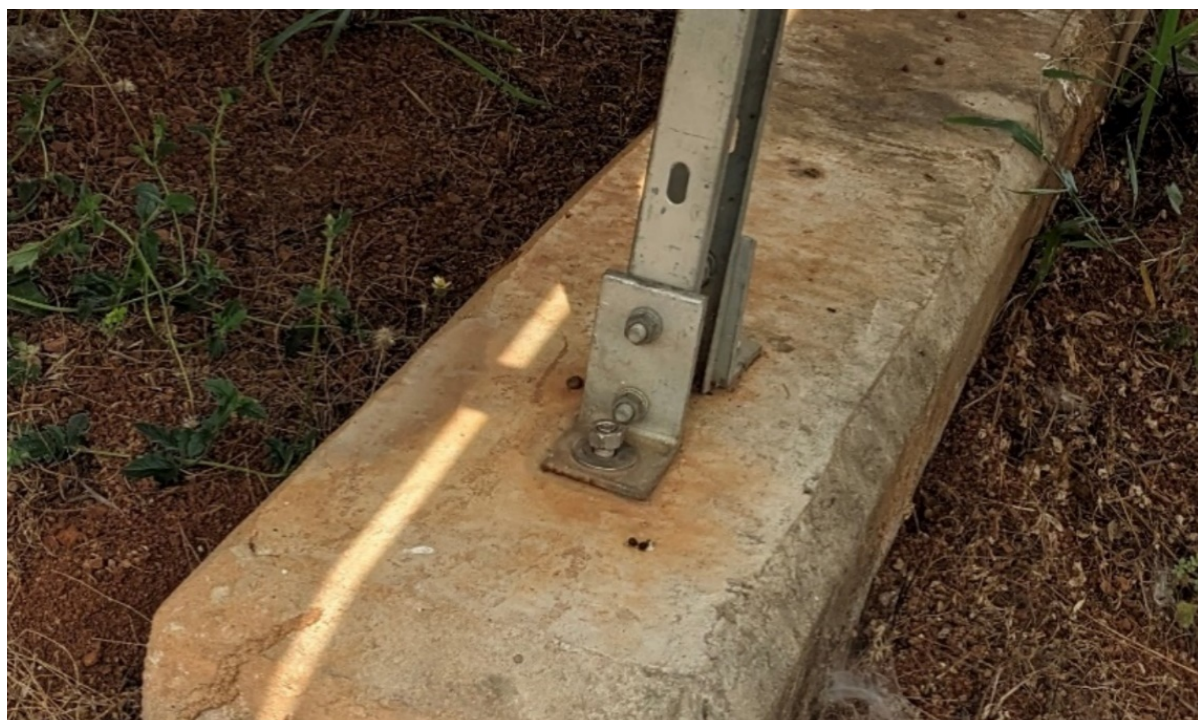
Figure 5 : Exemple de structure desserrée
