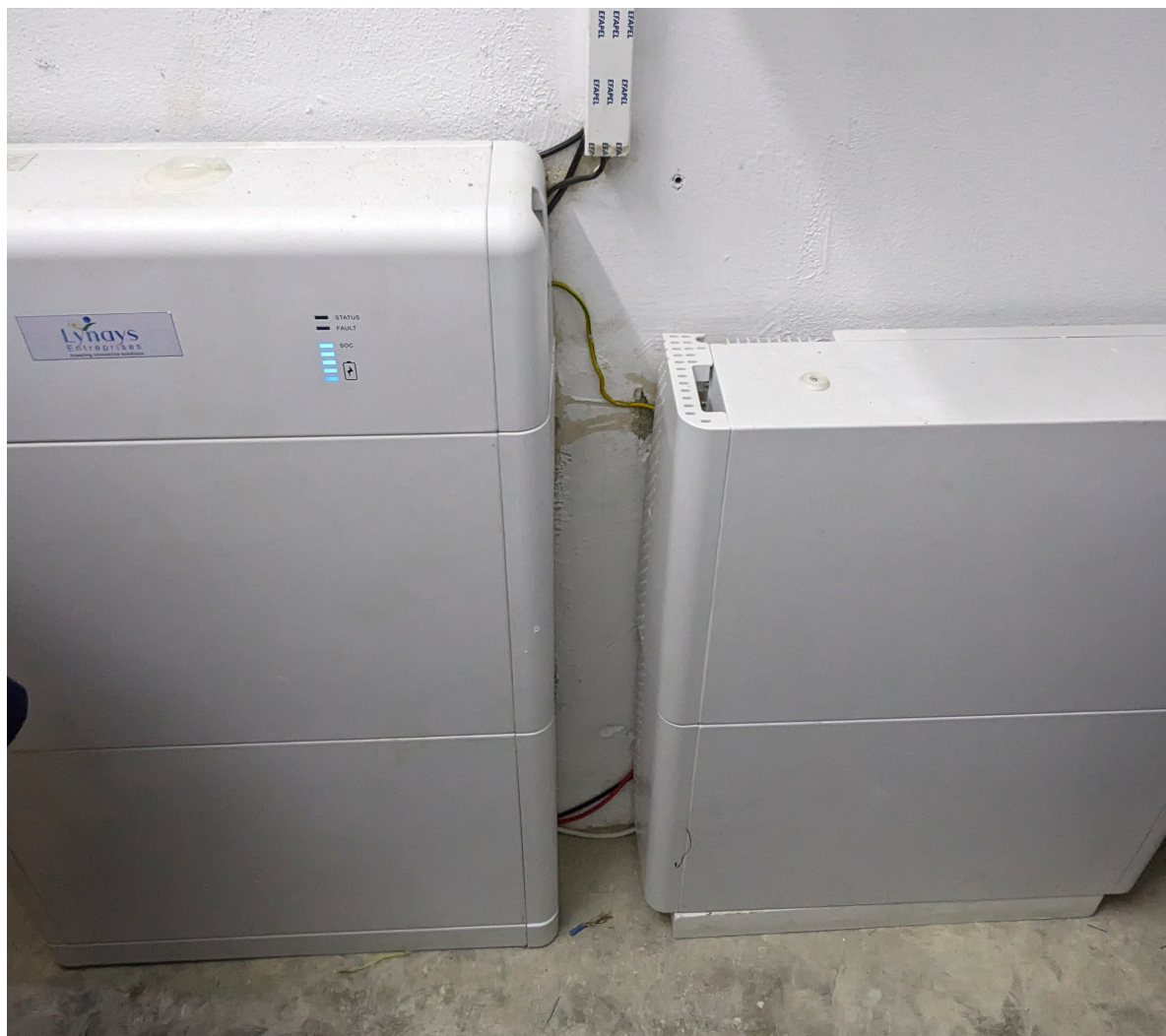
Figure 20 : Batterie à nettoyer et terre à rendre continue
