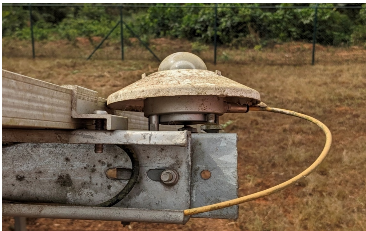
Figure 23 : Pyranomètre nécessitant un nettoyage et recalibrage
