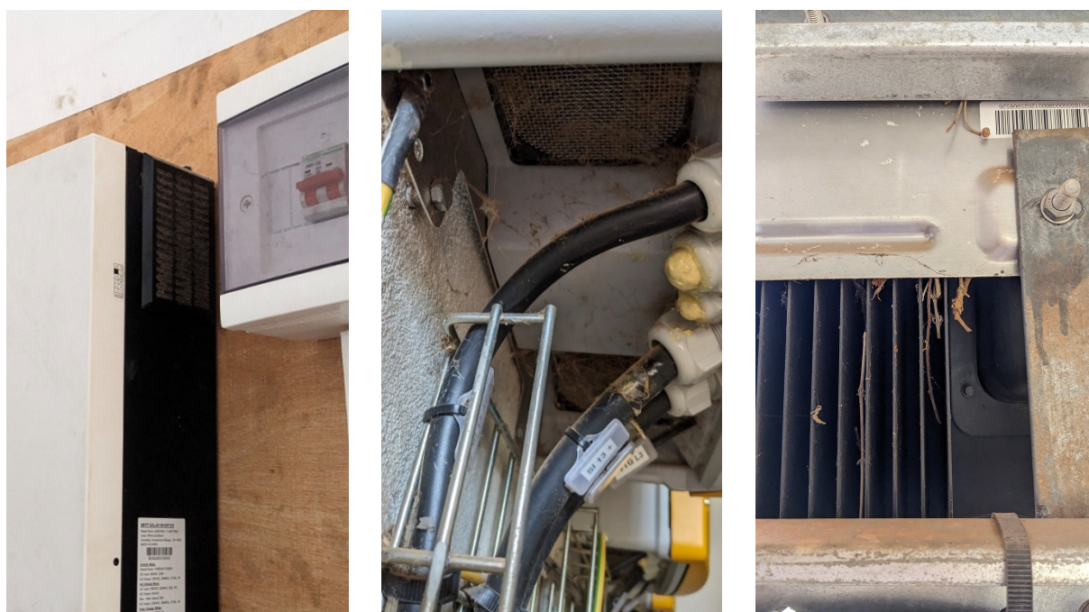
Figure 18 : Exemples d'onduleurs à dépoussiérer et nettoyer
