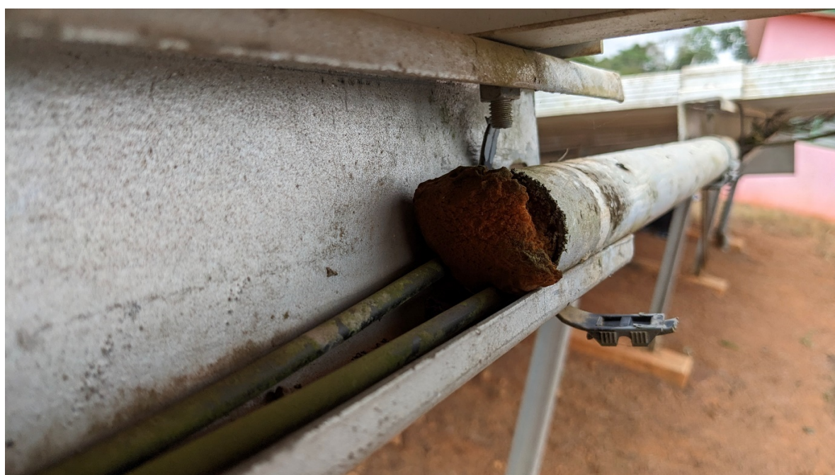
Figure 12 : Exemple d'attache en plastique et de mousse à remplacer
