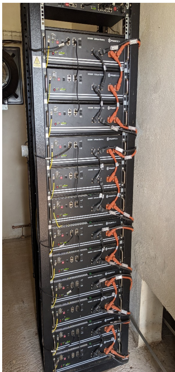
Figure 21 : Exemple de rack de batterie
