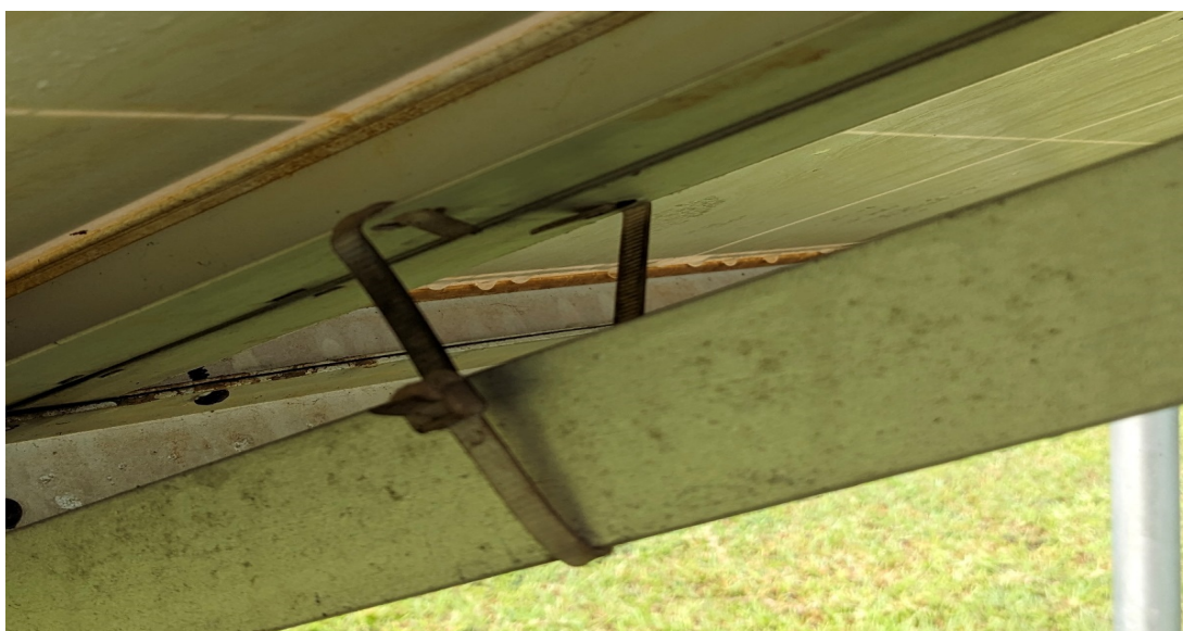
Figure 7 : Attache plastique à remplacer par une fixation pérenne
