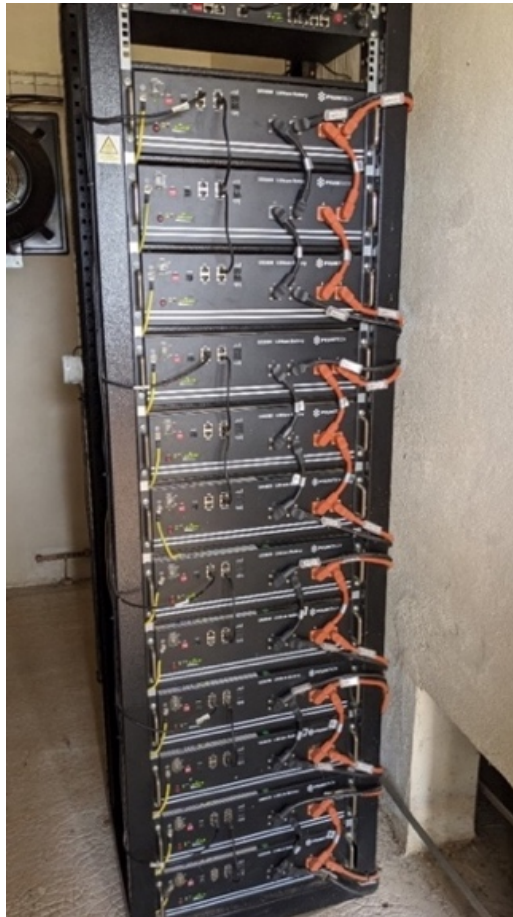
Figure 18 : Exemple de rack de batterie
