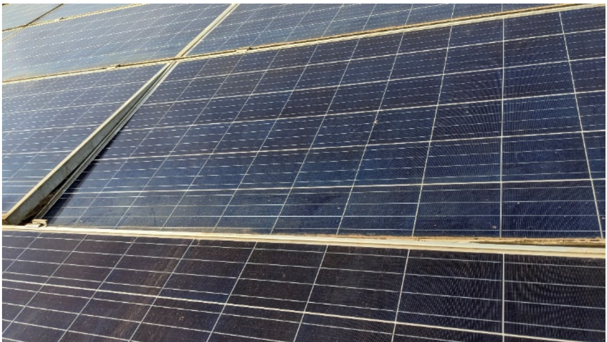
Figure 6 : Exemple de module mal fixé sur son étrier
