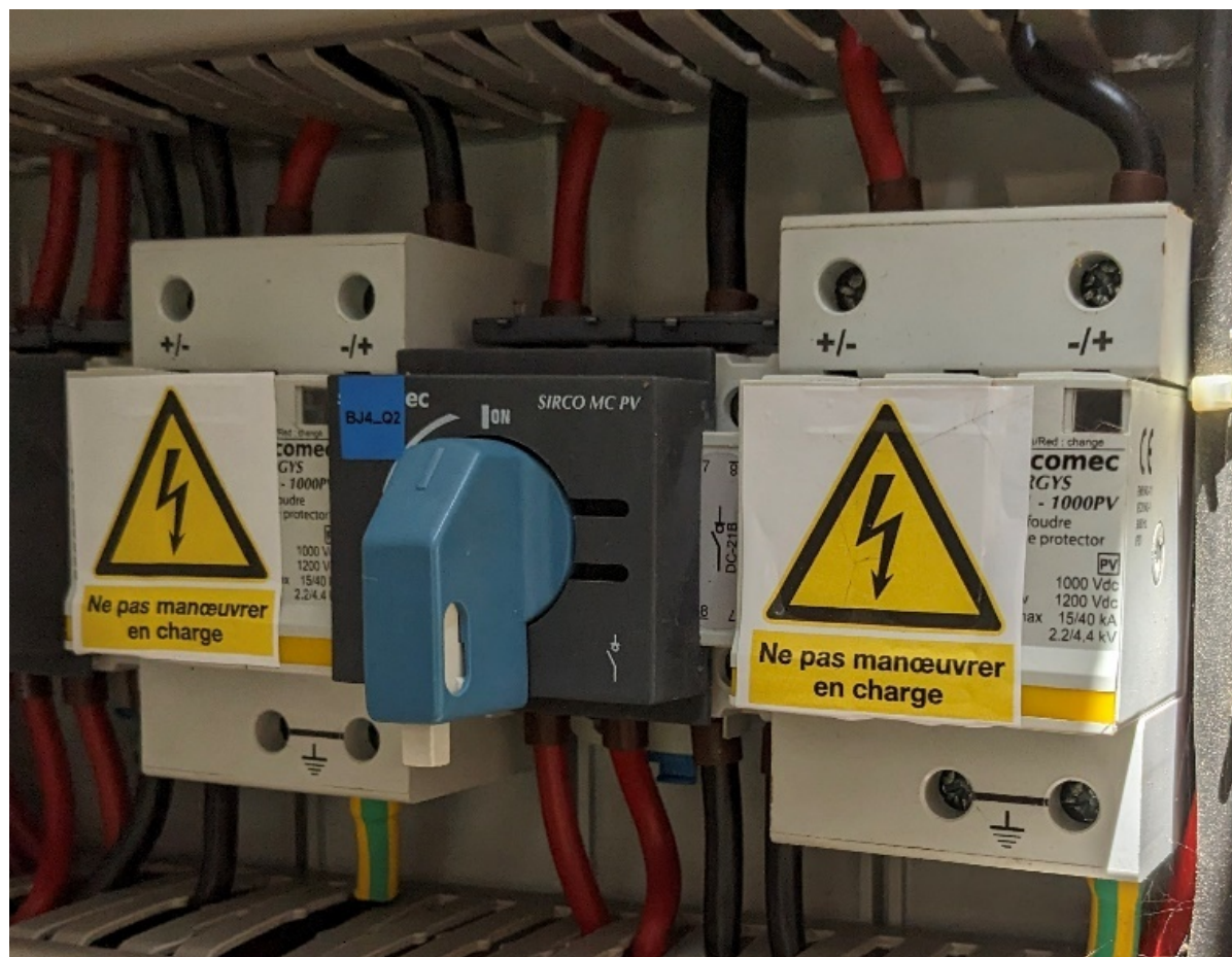
Figure 15 : Exemple de placement incorrect d'étiquette
