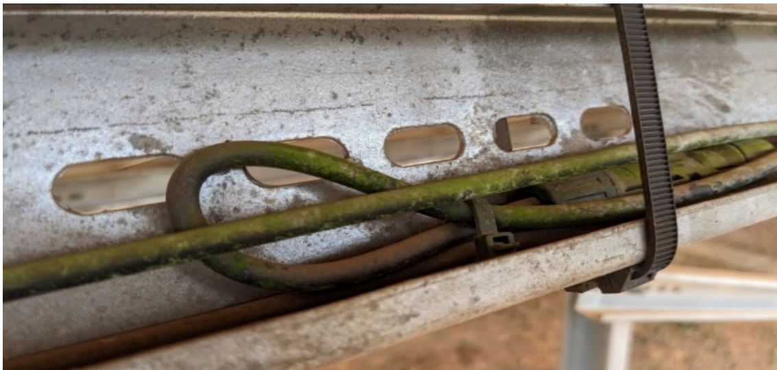
Figure 13 : Exemple de dégradation avancée de câble DC à l'ombre
