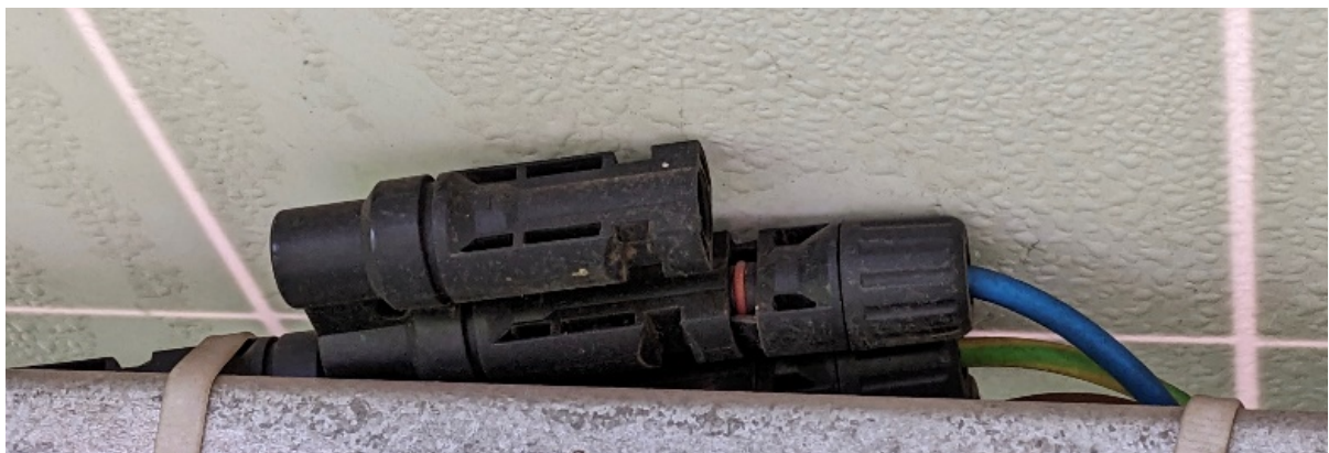
Figure 9 : Mauvais exemple de connecteur
