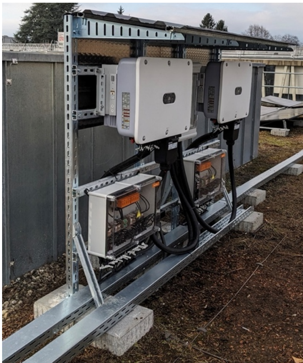
Figure 21 : Exemple d'installation d'onduleurs en toiture sur une structure adéquate avec une bonne protection des câbles
