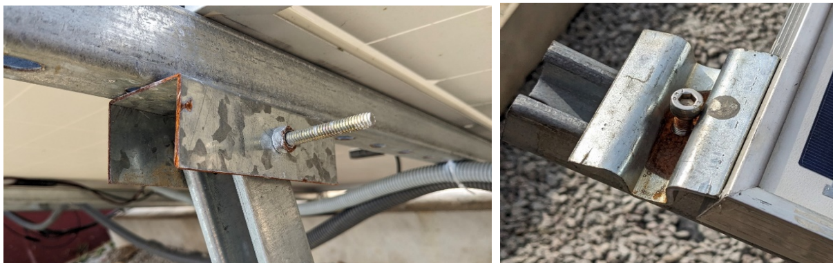
Figure 1 : Exemples de corrosion sur des éléments de structure non adaptés
