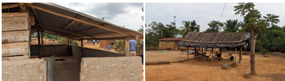
Figure 2 : Exemples de toitures inadaptées
