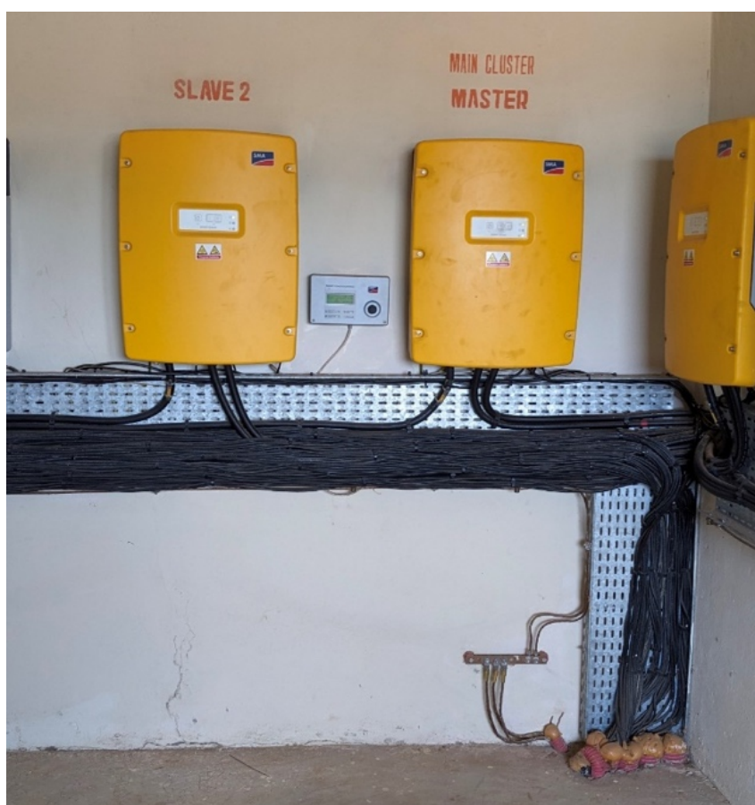
Figure 22 : Exemple de câblage AC / DC non conforme, car sans séparation
