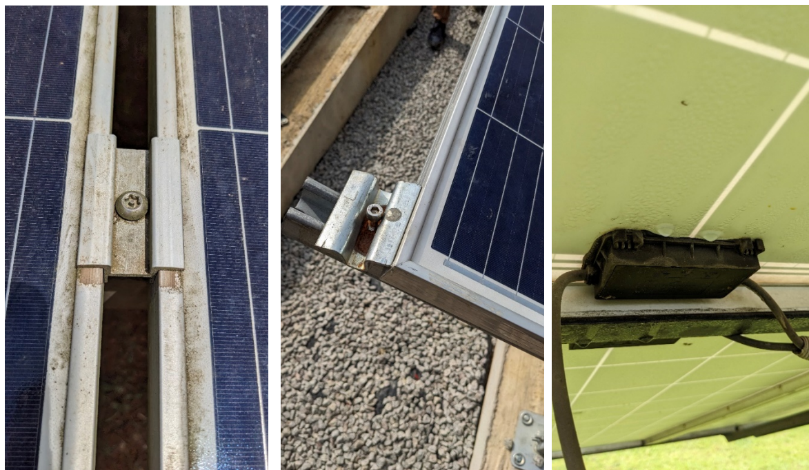
Figure 8 : Exemples de pinces de module s'étant déplacées à cause d'un mauvais serrage (gauche et centre) et d'une boîte de jonction en bas accumulant l'humidité, le panneau devrait être dans l'autre sens avec la boîte de jonction en haut
