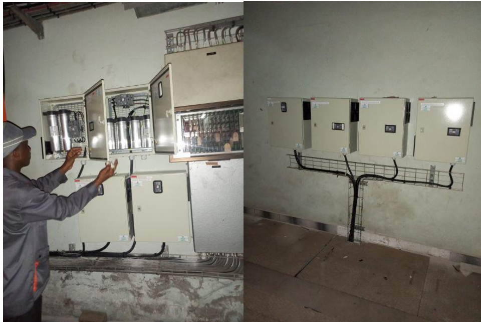
Photo : vue de quelques batteries BT installées à la fondation
