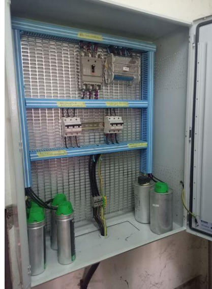
Vue de la batterie installée au parc des sports de Treichville
