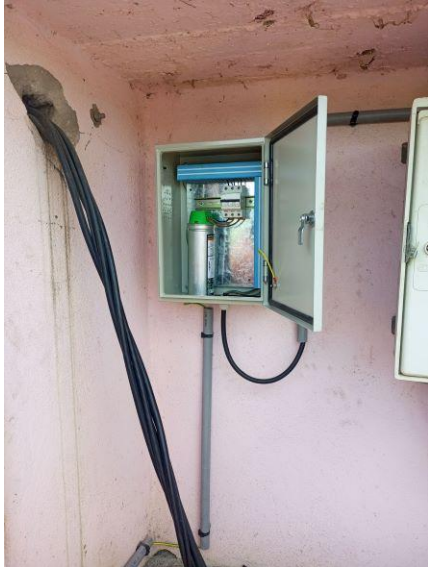
Vue de la batterie installée à CM de KAOURA
